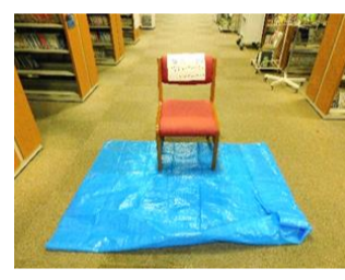
ブルーシートに覆われた床
